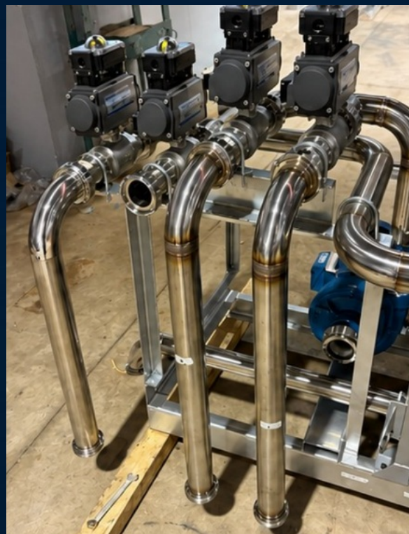
Conjunto de tubulação em inox
